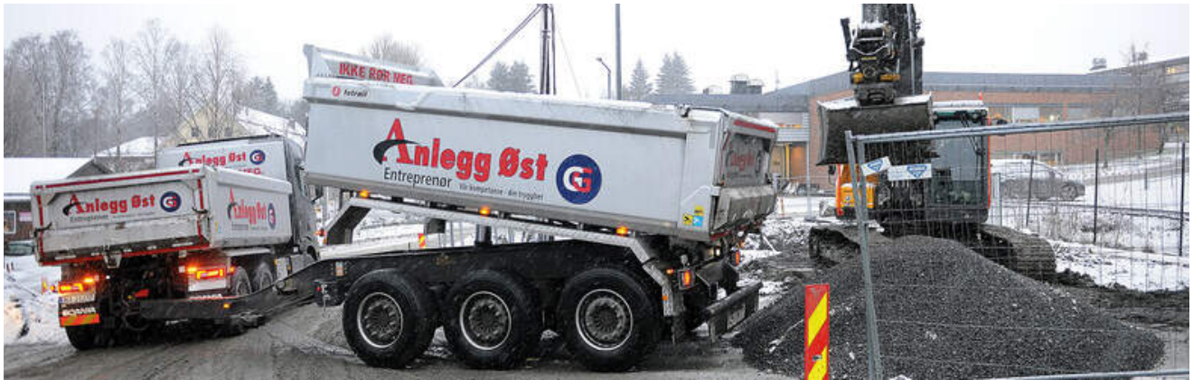
Anlegg Øst Entreprenør AS er tilbake på stasjonsområdet på Skarnes. Entreprenøren bygde ny undergang ved stasjonen i 2016. (Foto: Anlegg Øst Entreprenør)
