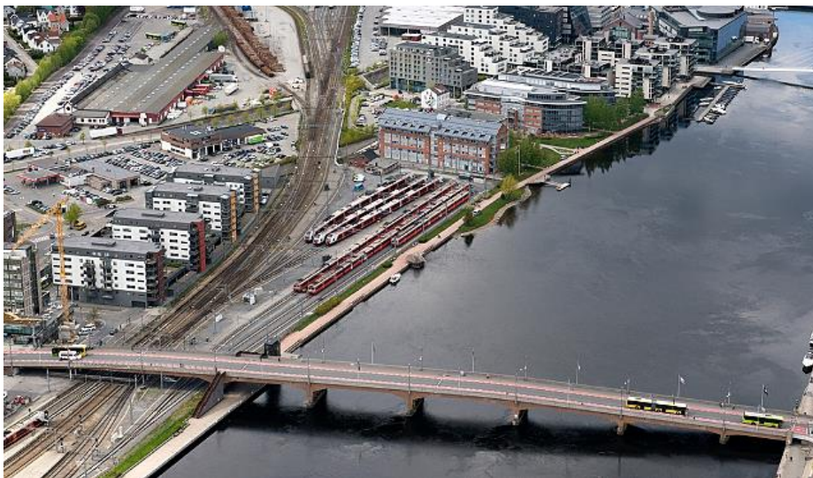
Drammen stasjon skal bygges om som en del av Intercity-prosjektet Drammen-Kobbervikdalen. Arbeidene er i gang.
