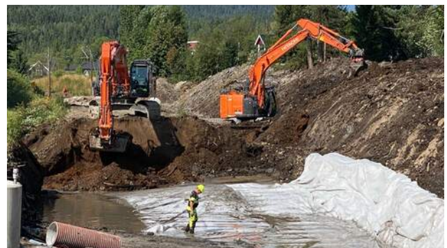
Her byttes det masser under sporene der det i perioder var så våt jord at toget måtte senke farten for å passere. Foto: Halldis Skogen, Bane NOR.
