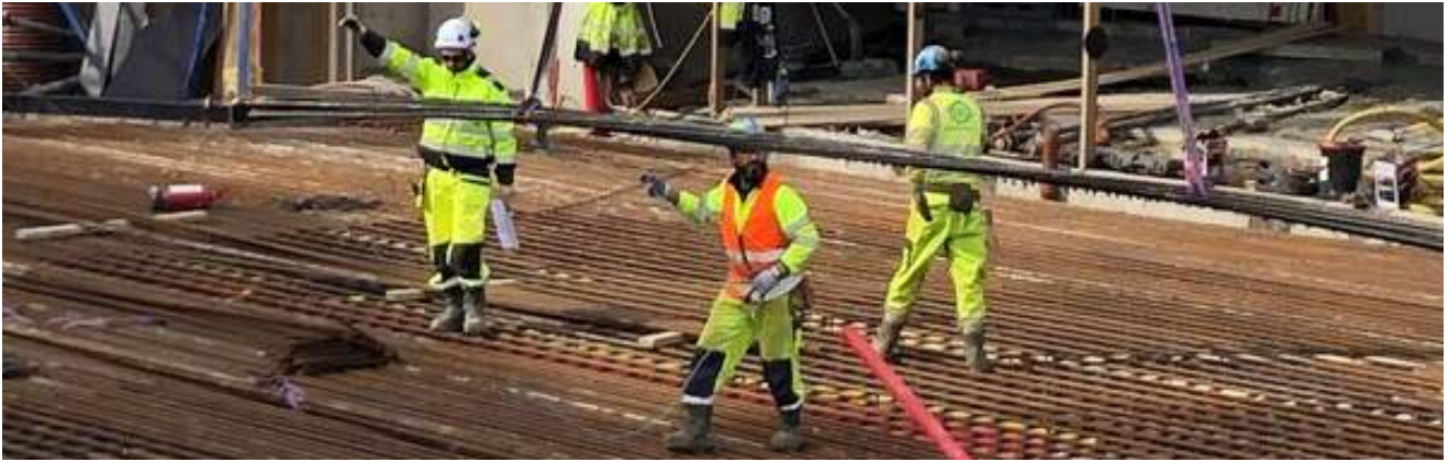
SKI STASJON: Entreprenøren har armert og støpt 1/4 del av plattform 3. Tilsammen vil det gå med nesten 2500 m3 betong før plattformen står ferdig. Foto: Bane NOR.
