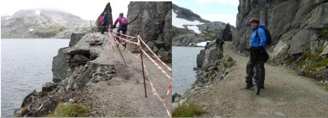
Tv: Mur ved Høgda som glei ut i vårløysinga 2013.Th: Reparert seinhaustes same år.
