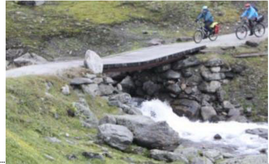
Th: Overbelasta bjelkebru.
