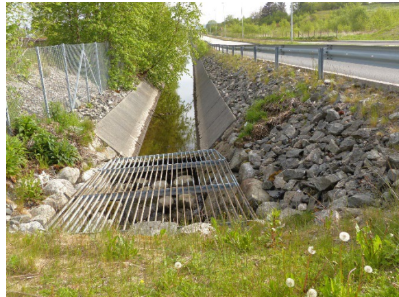
Figur 36. Bekken mellom Fabrikkveien og jernbanen foreslås lagt mellom banen og godsterminalen, i åpen grøft.
