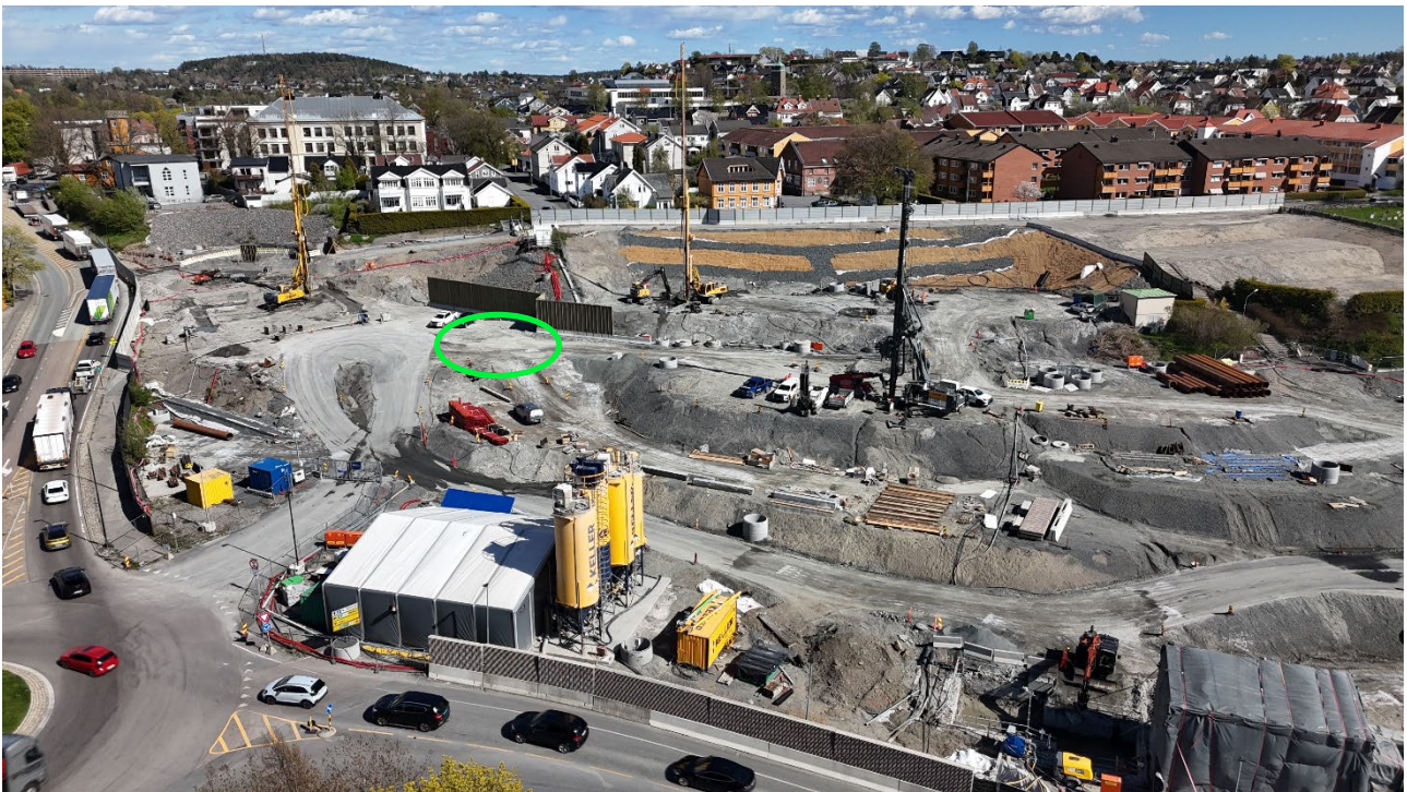
Figur 1. Testboring av stålrør i betongforsterket grunn skal gjøres innenfor grønn sirkel. Vi har startet med å sette opp en midlertidig støyvegg (rett bak den grønne sirkelen). Dronefoto 4. mai 2026: Bane NOR.
