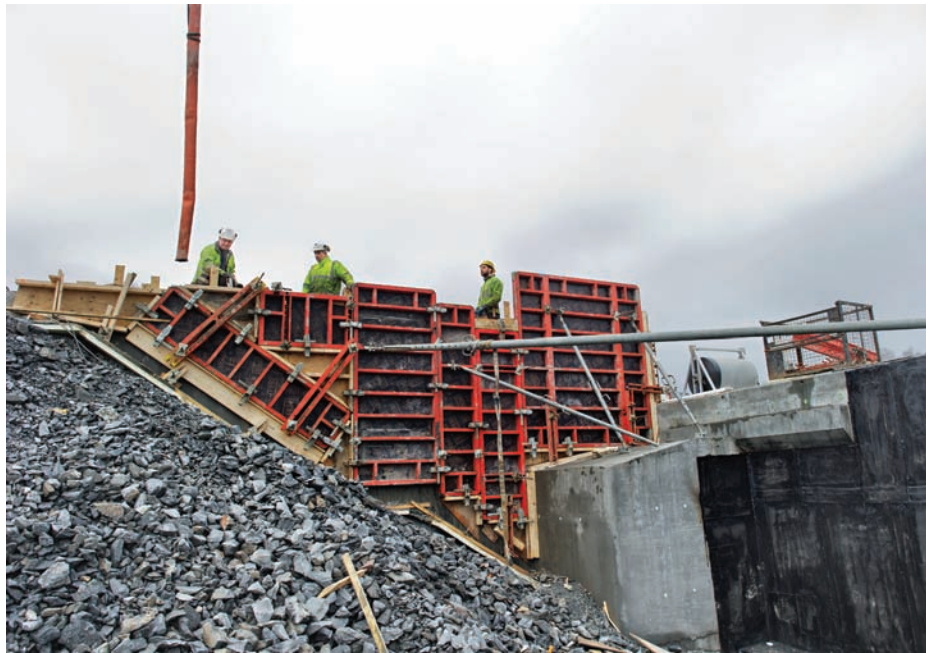
I tiden som kommer blir det mindre graving og sprenging, men mer betongarbeider og tilbakefylling på stasjonsområdet. (Foto: Hilde Lillejord)
