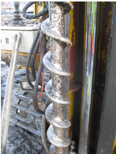
Figur 2: Svart avfarging på naverbor ved Halden Driftsbanegård etter boring i dypere liggende masser
