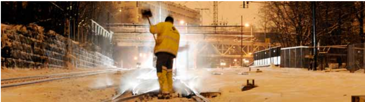
Sporvekselvarme Foto: Øystein Grue/Jernbaneverket
