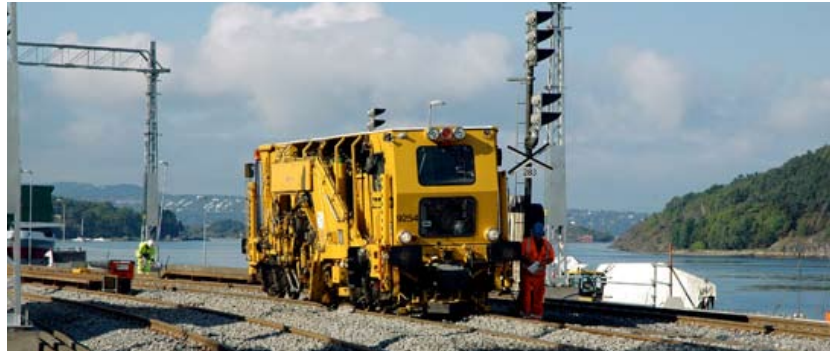
Midlertidig dobbeltspor bygges ved Loenga i forbindelse med byggingen av Operaen og senketunnelen i Bjørvika. Foto: Njål Svingheim
