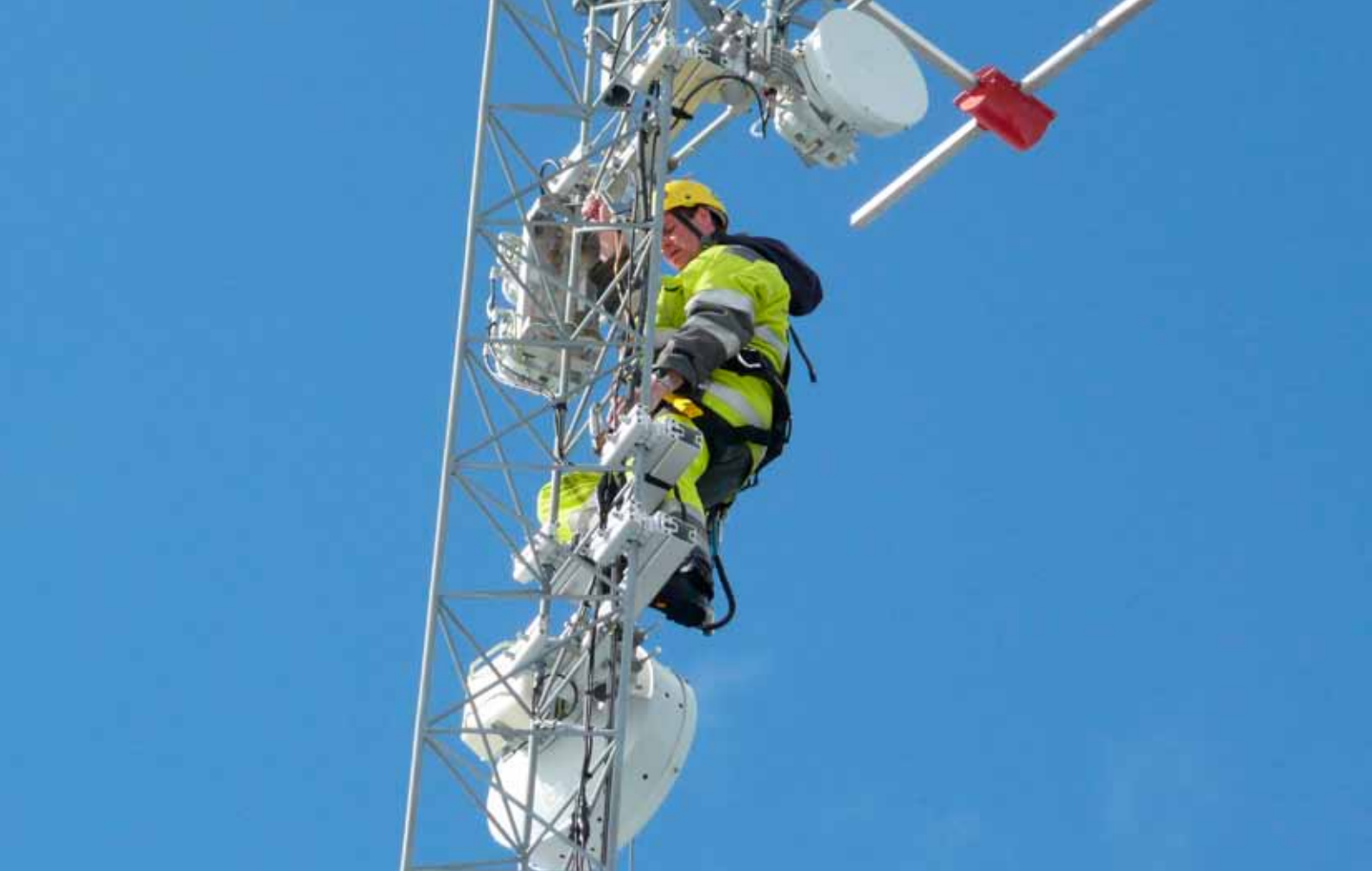
Kontroll av GSM-R utstyr, Støren. Foto: Steinar Austli/Jernbaneverket
