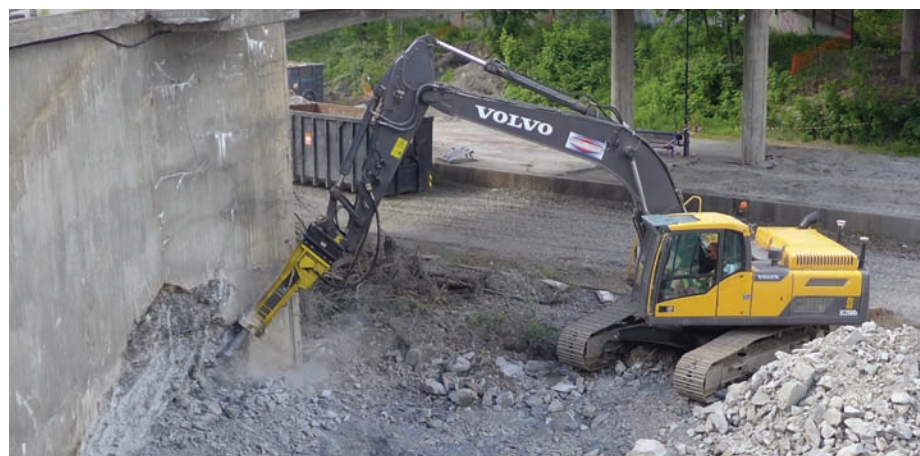
Pigghammeren brukes både til å rive betong og gamle konstruksjoner, samt til å fjerne fjell i det fremtidige sporområdet. Ved pigging av fjell benyttes en større hammer.
